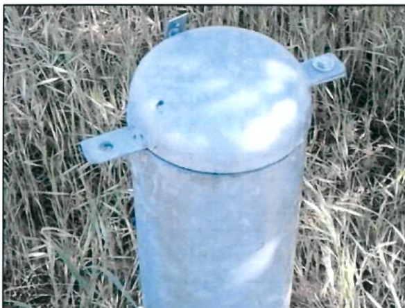
Capot métallique non verrouillable au droit du piézomètre Pz3
