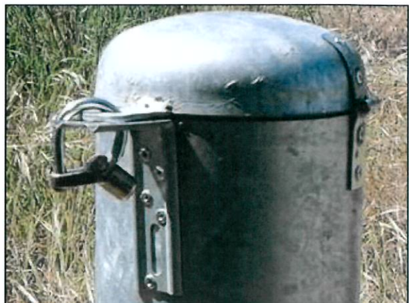
Verrouillage sécurisé du capot du piézomètre Pz3
