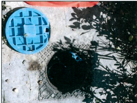
Bouche à clé du piézomètre Pz1 endommagé
